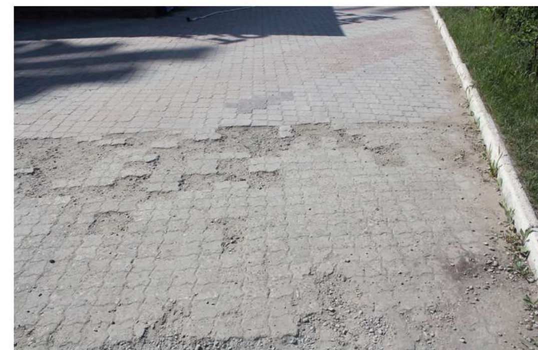
ПЛОХО. Использование некачественных материалов, бетонная
