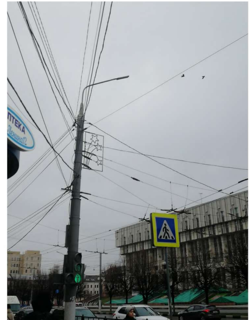
ПЛОХО. Недопустимая воздушная прокладка проводов
