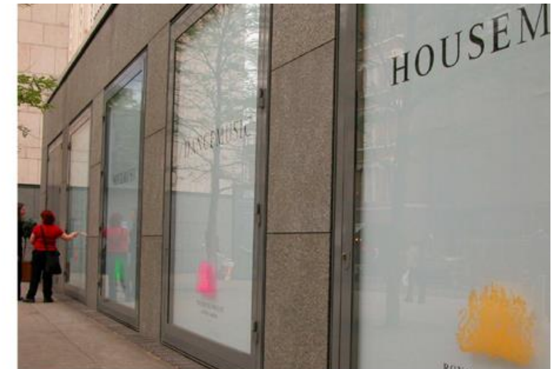
ПЛОХО. Остекление полностью закрыто
