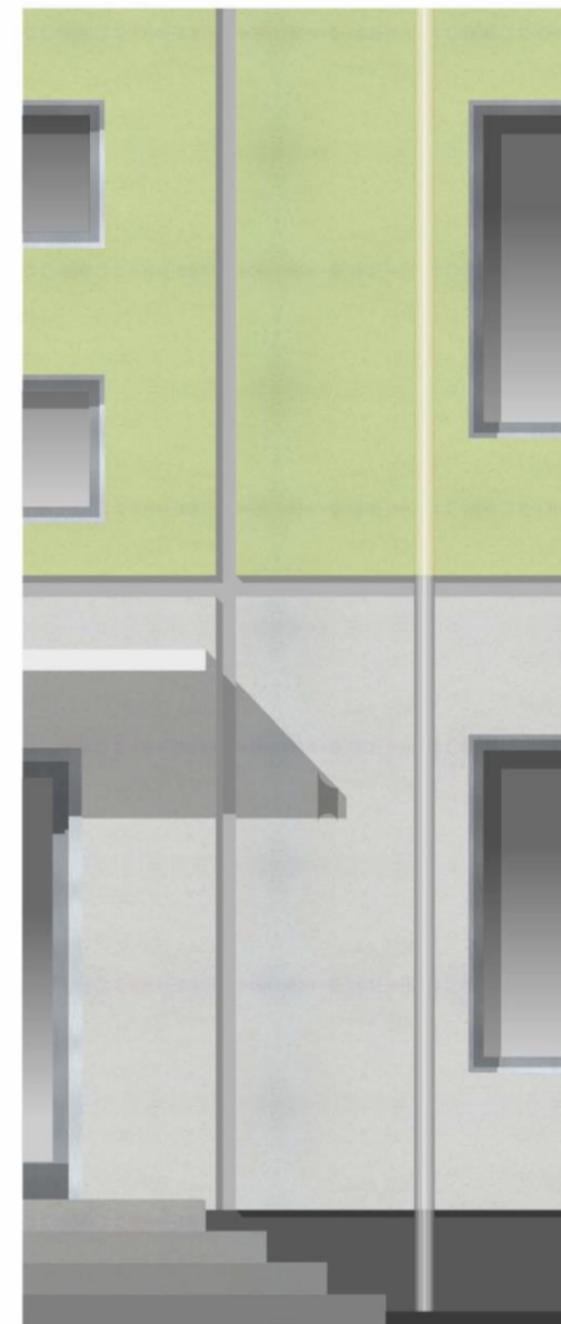
ХОРОШО. Водосточная труба соединена с ливневой канализацией
