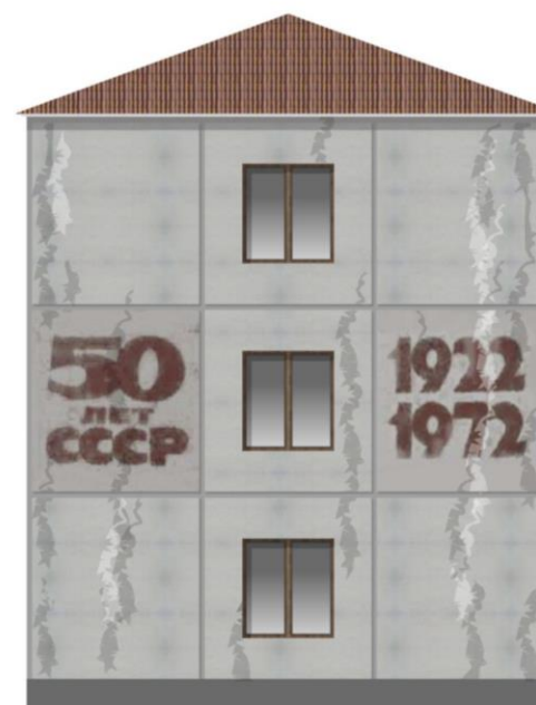
ПЛОХО. Исторические декоративные элементы фасада находятся в плохом состоянии, нуждаются в сохранении и реставрации
