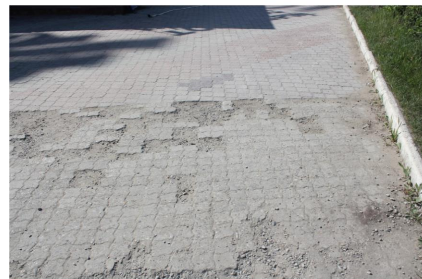
ПЛОХО. Использование некачественных материалов, бетонная
