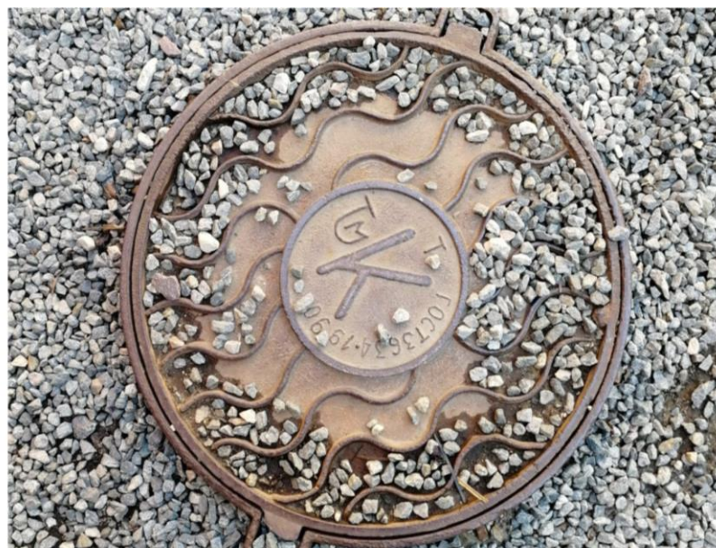
ПЛОХО. На крышке люка скапливается вода и мелкие камни
