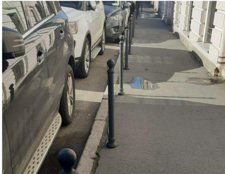
ПЛОХО. Покрытие пешеходного тротуара из асфальтобетона недопустимо
