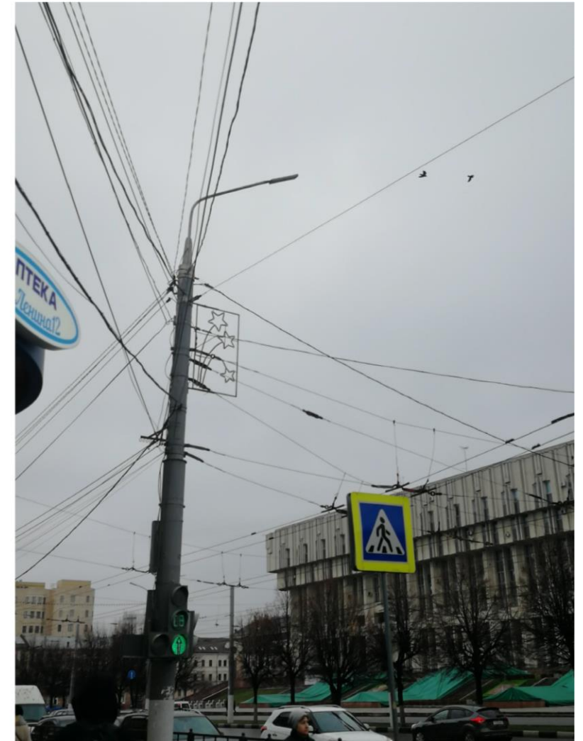
ПЛОХО. Недопустимая воздушная прокладка проводов
