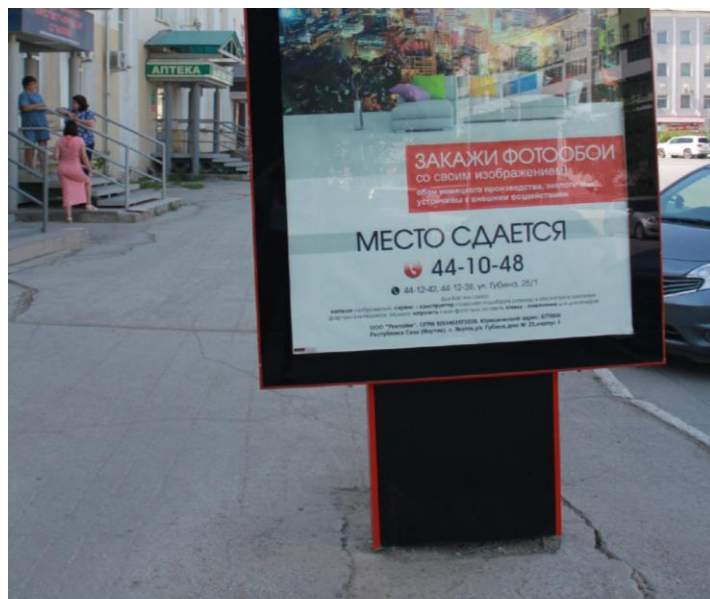
ПЛОХО. Некачественная врезка металлических столбов в мощение
