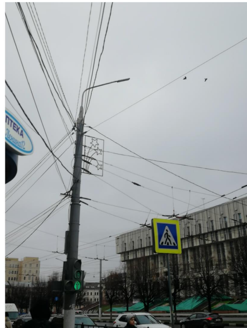
ПЛОХО. Недопустимая воздушная прокладка проводов
